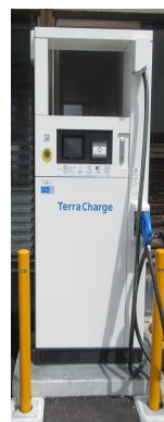
道の駅 急速充電設備
