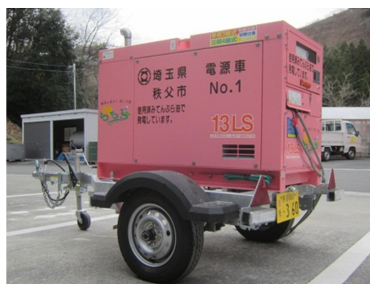
牽引式発電機 （燃料に BDF を使用）
