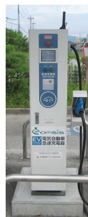
道の駅ちちぶ 急速充電器
