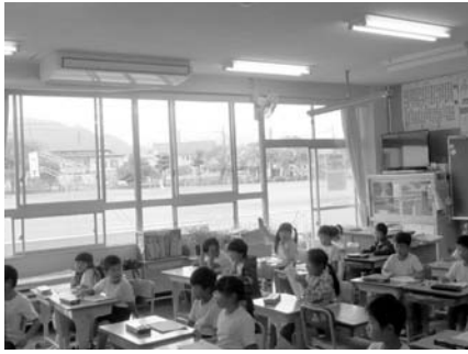
南小学校に設置されたエアコン
