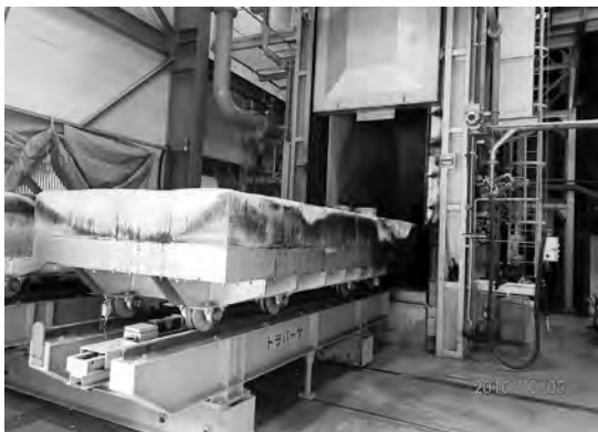
有害鳥獣処理施設の動物炉（福井県若狭町）
