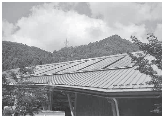
元気村に設置された太陽光パネル
