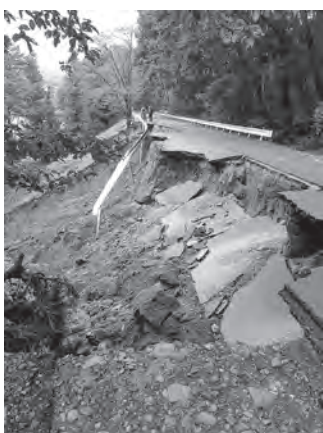
台風19号による道路崩壊現場
