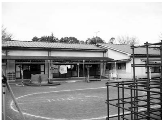
老朽化対策が求められている星の子教室
